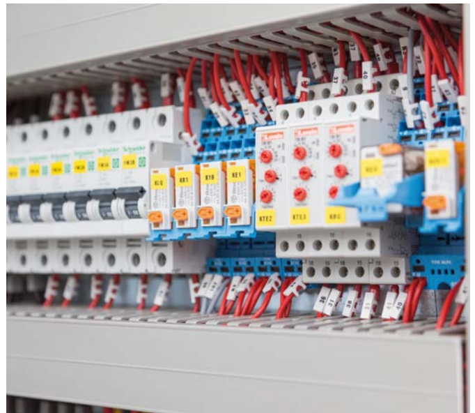
Logischer, geordneter und „aufgeräumter“ Aufbau im Schaltschrank
